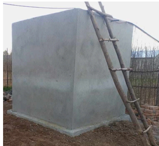
Réservoir de stockage et rétention d'eau
