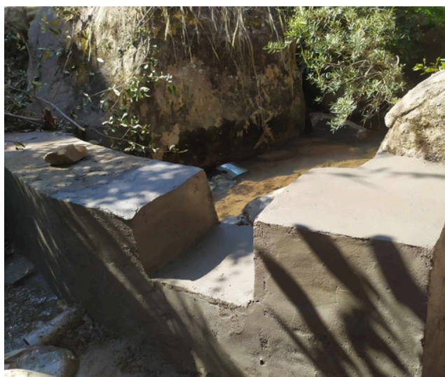
Captage de source pour irrigation en mode gravitaire
