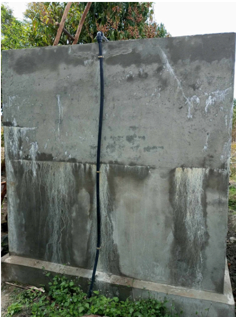
Mauvaise conception de réservoir avec les locaux
