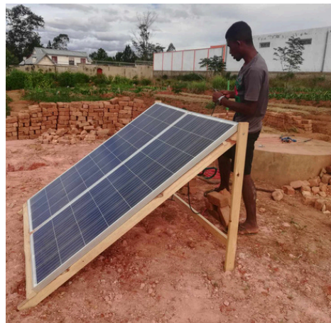
Système de pompage solaire
